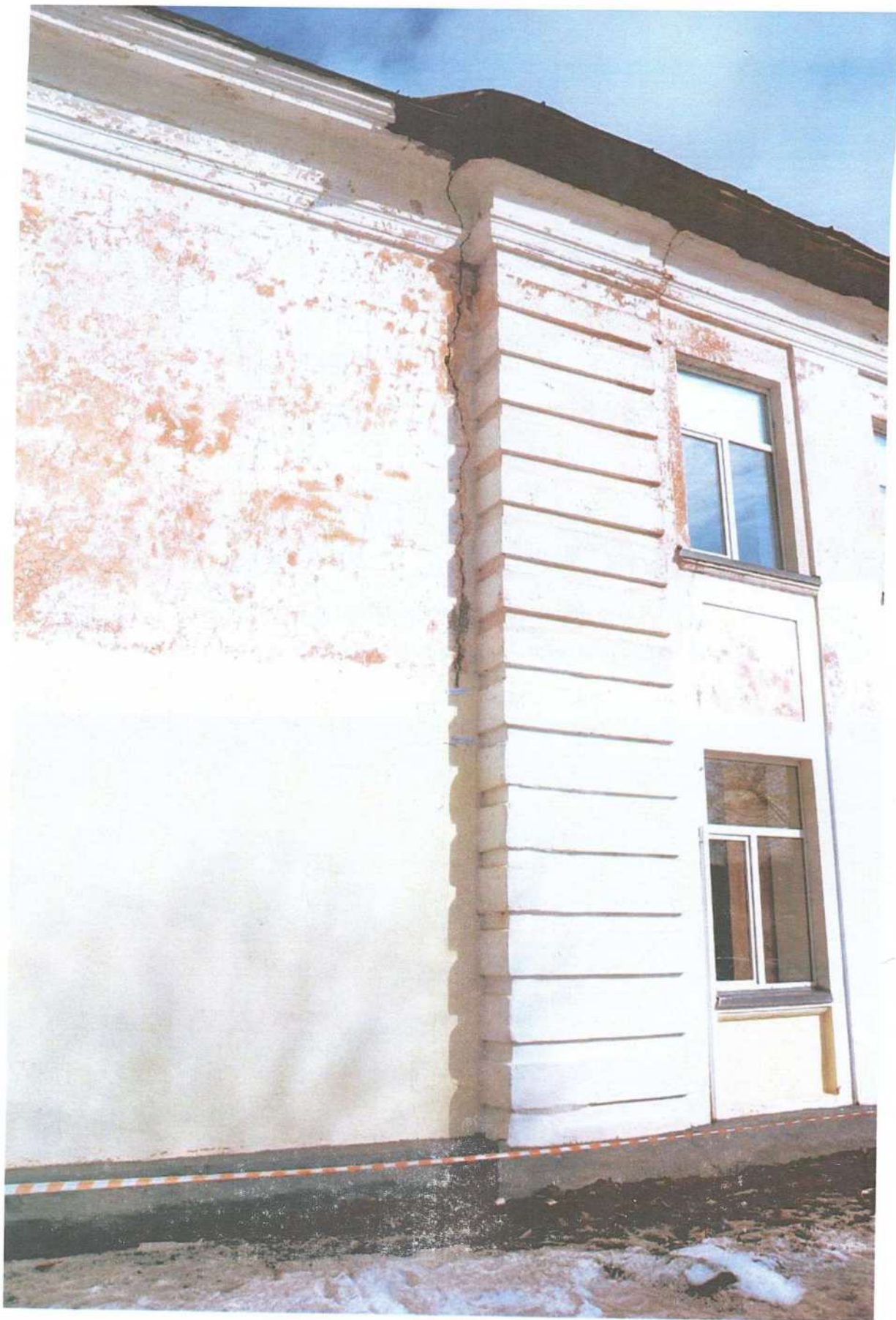
Фото 1. Главный фасад – стена по оси А. Вертикальная трещина в кладке стены (слева от оси Ж)
