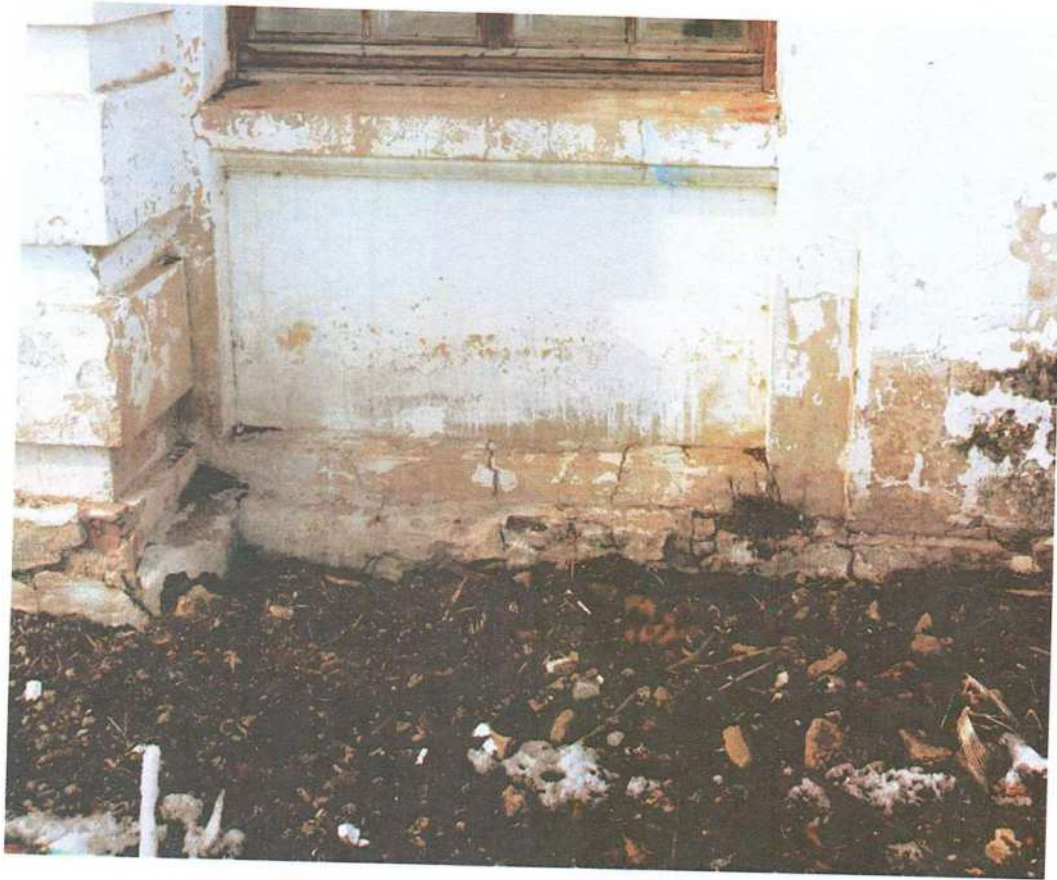
Фото 14. Состояние отмостки и цоколя стены по оси А
