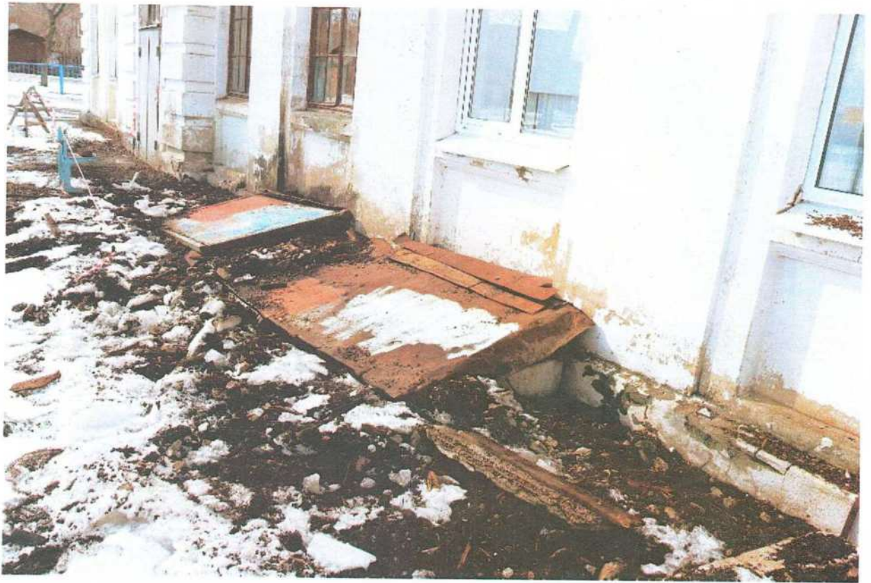
Фото 12. Пряжки у оконных проемов в стене подвала по оси А
