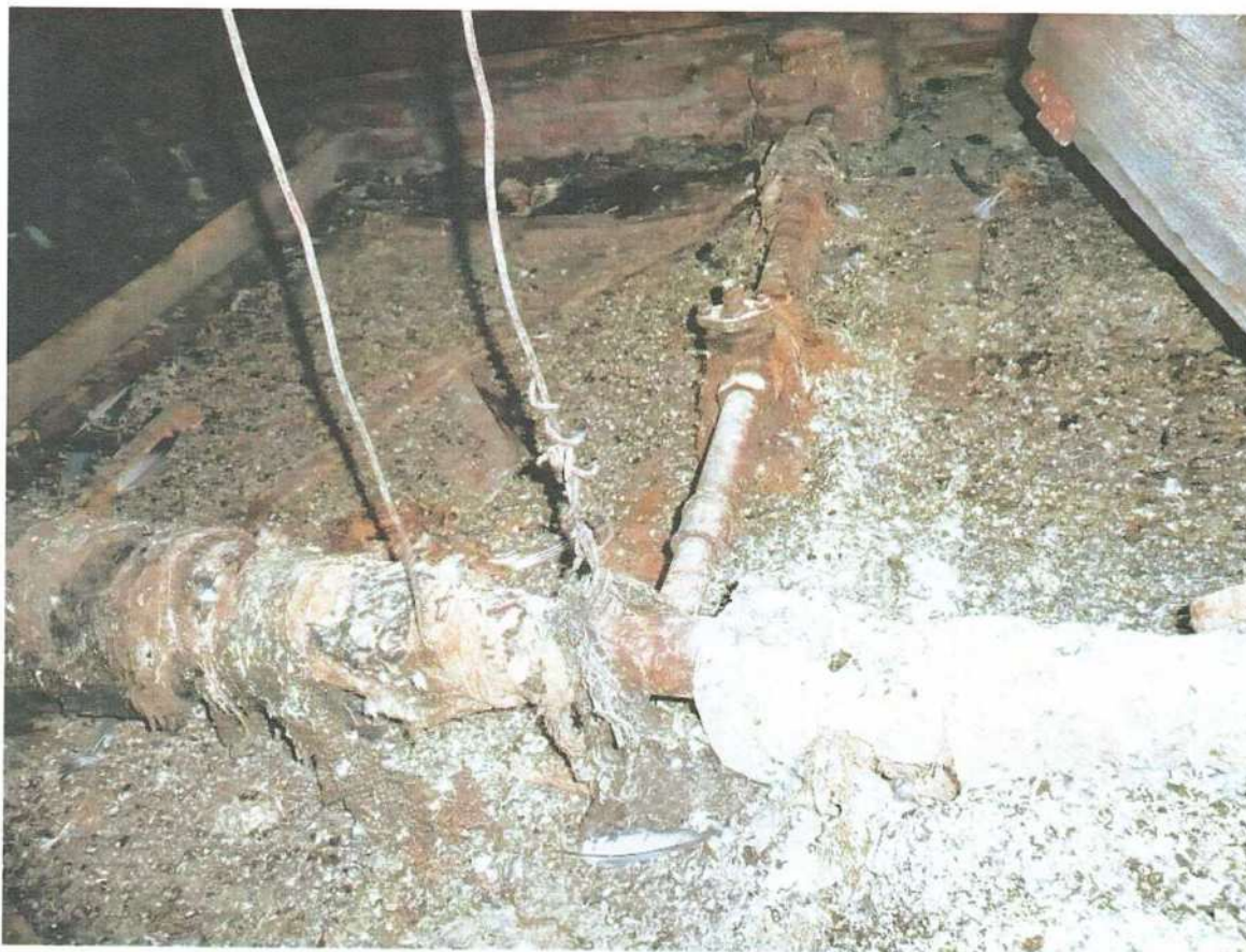
Фото 44. Состояние верхней подающей трубы отопления и отвода к стояку на чердаке
