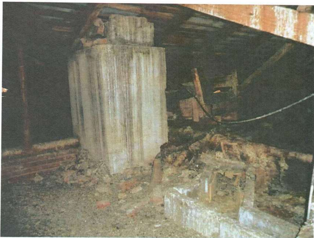
Фото 37. Дымовая труба из подвала (помещения бывшей котельной), расширительный бак отопления, поврежденный вентканал.
