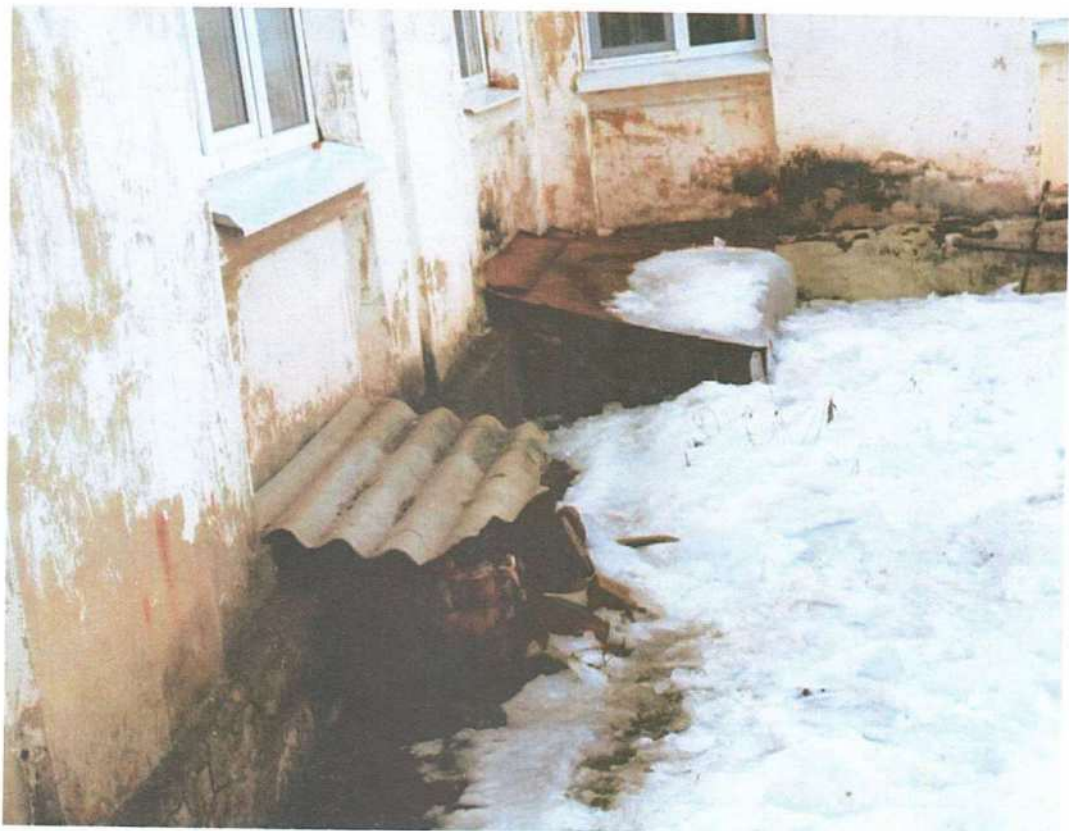
Фото 13. Пряжки у оконных проемов в стене подвала по оси 5
