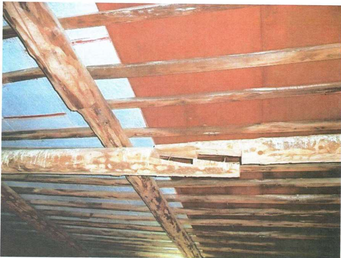
Фото 35. Дефект сопряжения прогона по длине.
