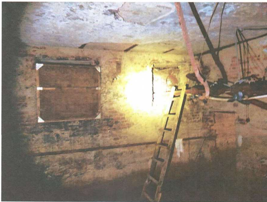
Фото 19. Состояние помещений подвала (помещения бывшей котельной) – ввод тепло-трассы через оконный проем в стене подвала
