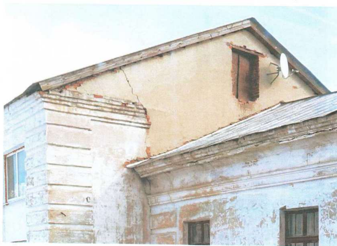
Фото 7. Трещина в кирпичной кладке фронтона по оси 7 (часть здания литера А1).
