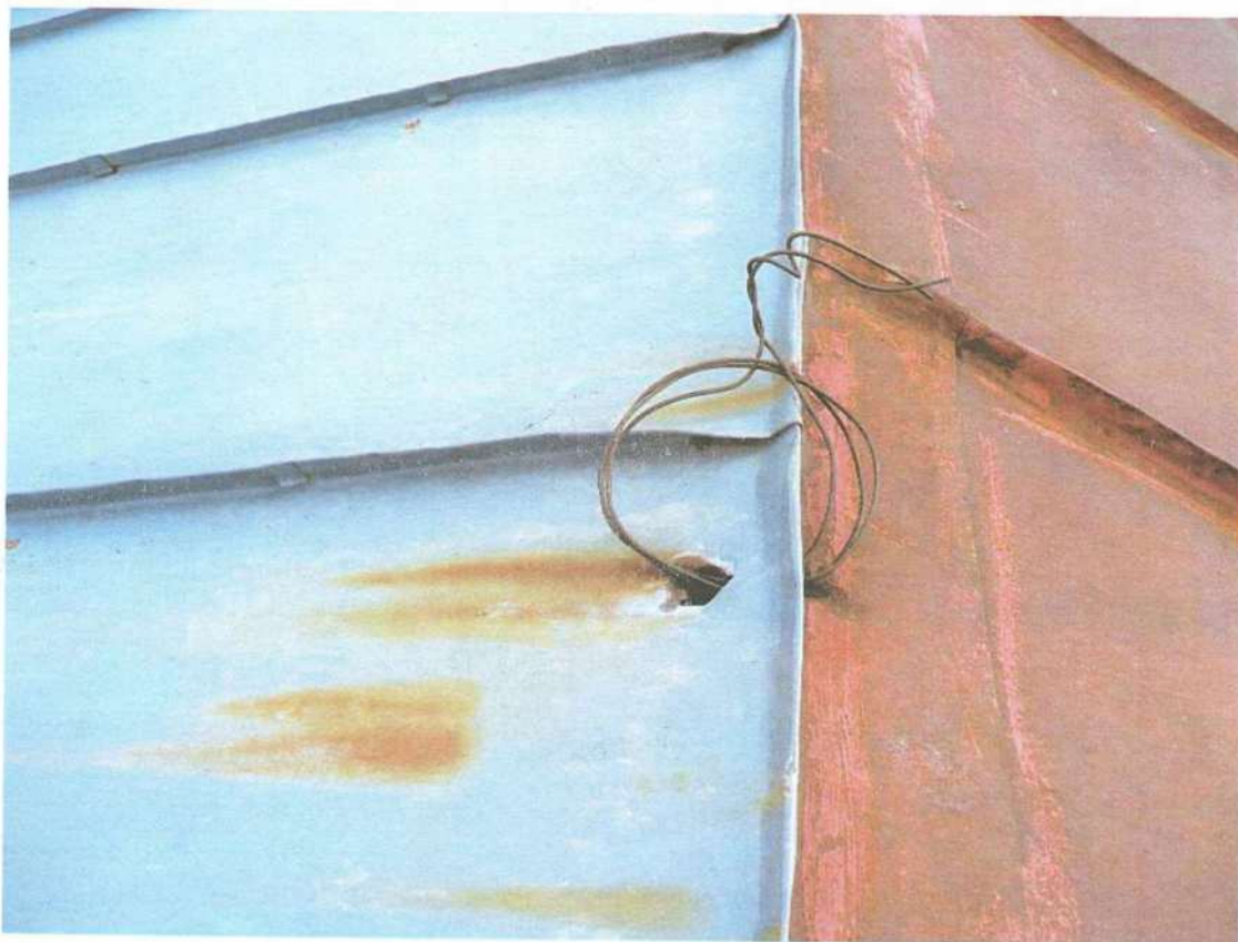
Фото 42. Пробоина в кровельном покрытии.
