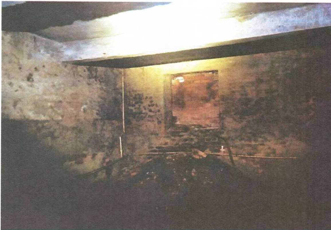
Фото 18. Состояние помещений подвала (помещения бывшей котельной) – оконный проем в наружной стене подвала заложен кирпичной кладкой
