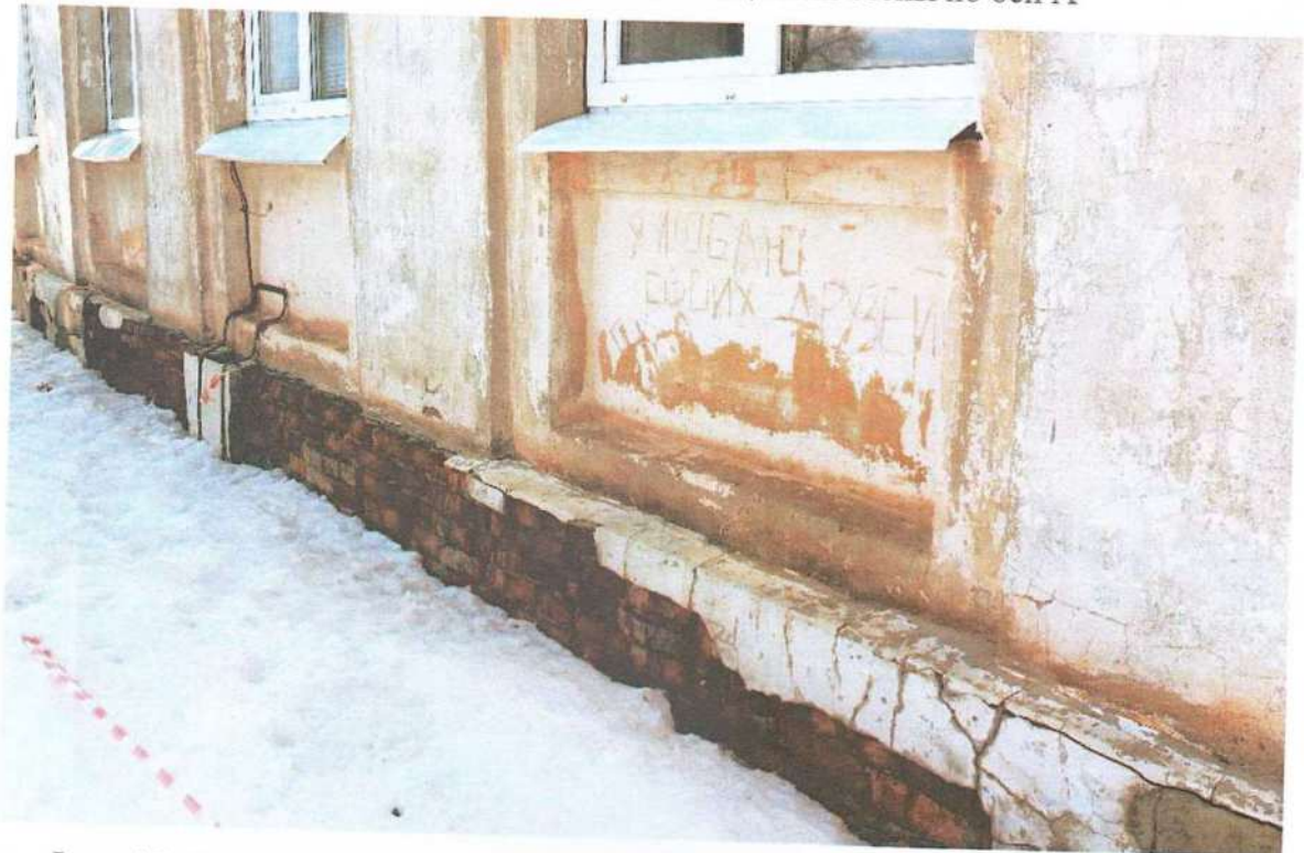
Фото 15. Состояний цоколя части здания литера А1 (стена по оси А в осях 7-8)
