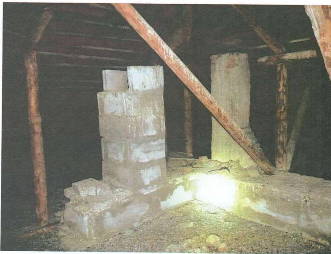
Фото 36. Вентканалы по чердачному перекрытию подходят к разрушенным вентиляционным трубам на чердаке литеры А
