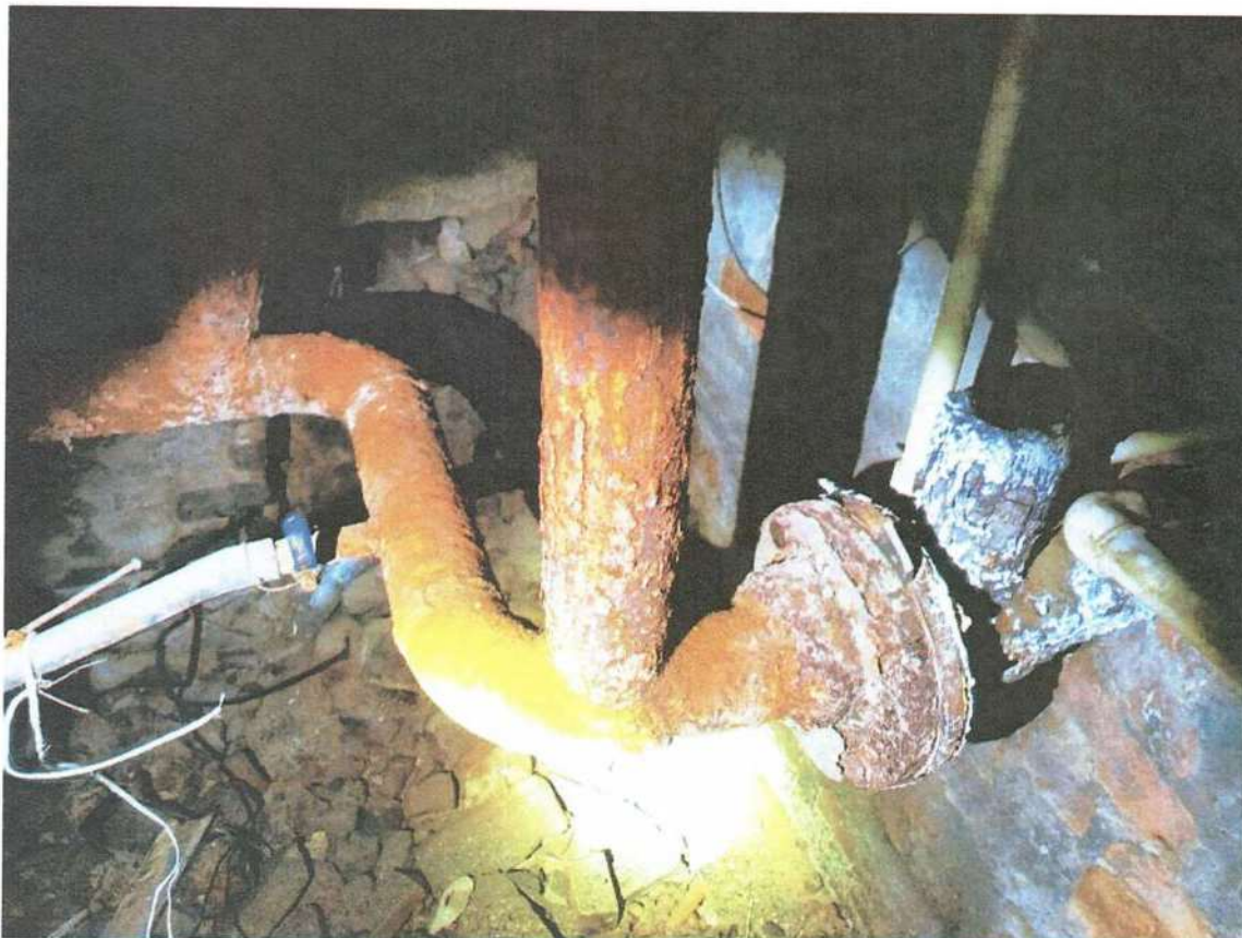
Фото 43. Состояние труб и задвижки системы отопления в подвале
