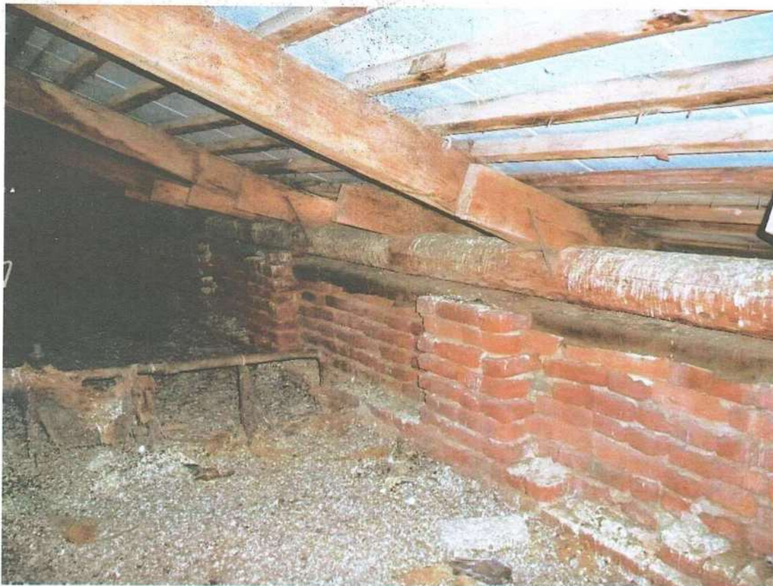
Фото 45. Состояние отвода к стояку отопления на чердаке – утепление трубы утрачено.
